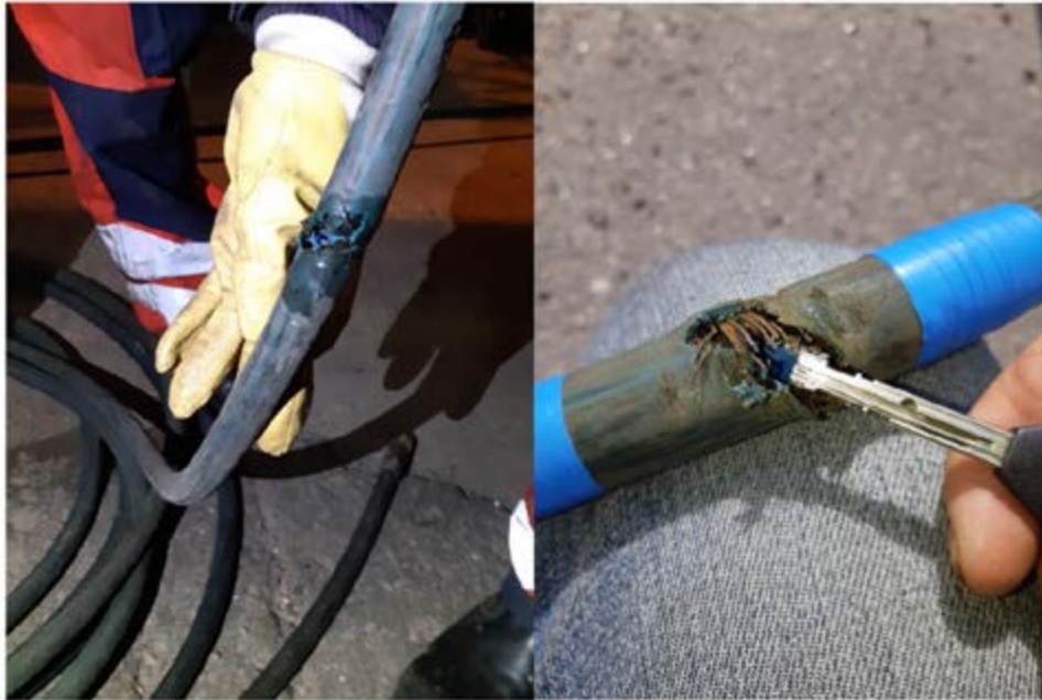
Kuva 28. Työn aikana vaurioitunut matoletku.
